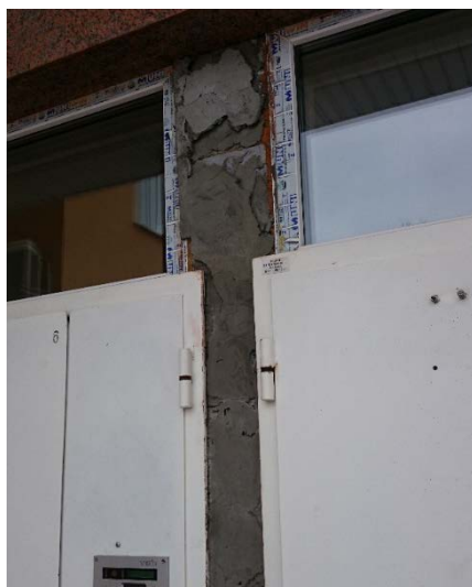
Отсутствует фасадная плитка на входной группе (1 подъезд).
