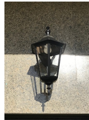
Установлены новые уличные светильники. Во всем доме ведется плановая замена ламп на энергосберегающие.
