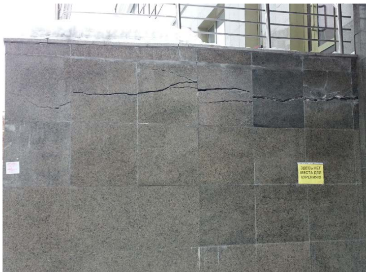
Образование трещины в стене отмостки.
